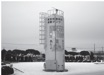
緊急用飲料水備蓄タンク
