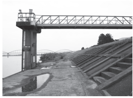
玉崎浄水場取水ゲート
