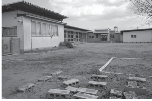
被災した東保育所
