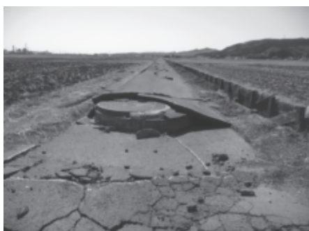
飛び出たマンホール
