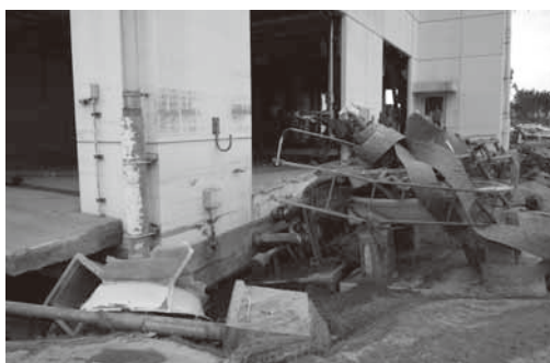
浄化センター処理棟北東部の被災状況
