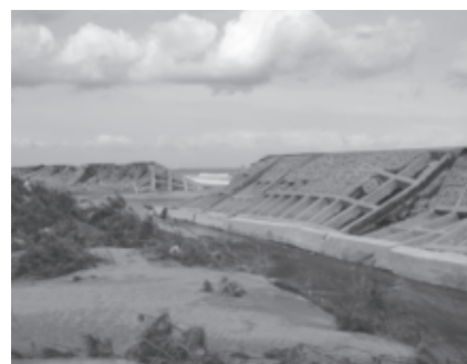
津波で破壊された防波堤
