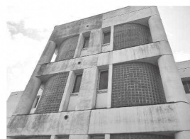
岩沼西小学校 外壁確認
