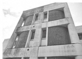
岩沼西小学校 外壁確認
